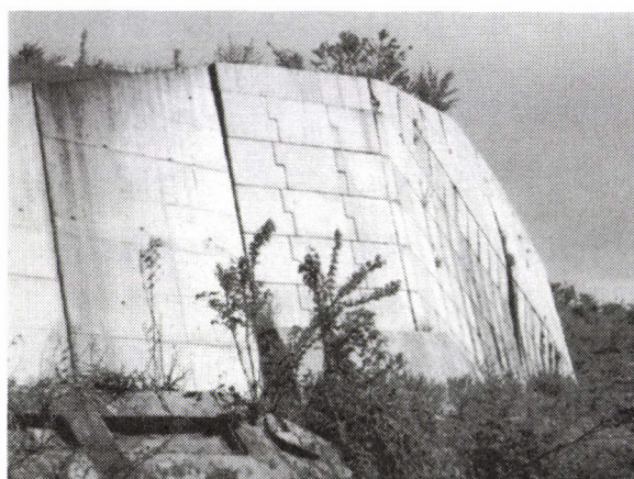
写真-9 パネルの圧壊
