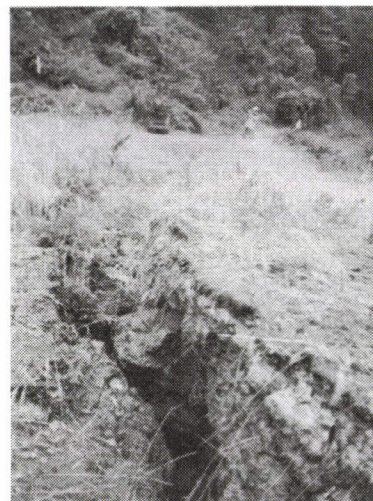
写真-2 天端の開口亀裂
