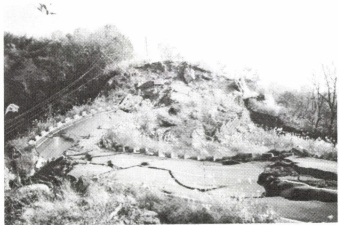
写真-7 林道道院線の崩壊状況
