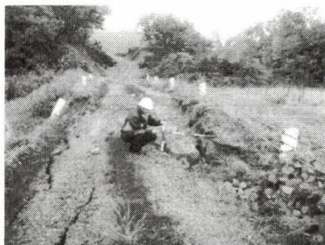
写真-4 天端の沈下と変形
