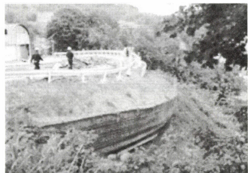
写真-6 ジオテキスタイル補強土壁の被災状況
