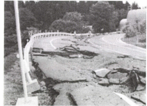
写真-2 道路面の被災状況
