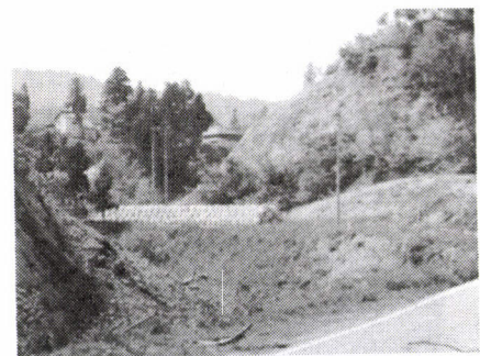
写真-5 補強土崩壊状況
