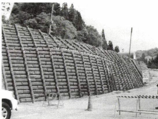
写真-3 井桁工法の変形
