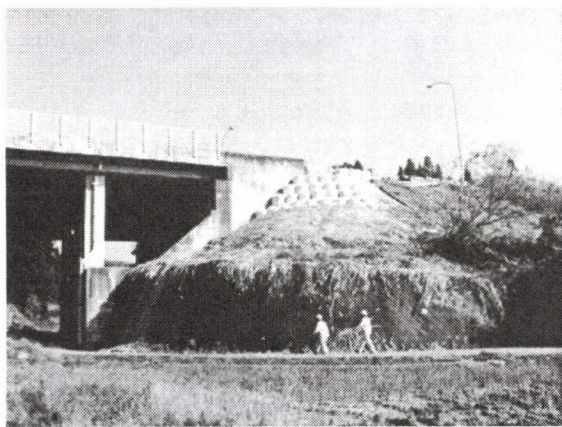
写真-9 擁壁 C の被害状況と地山の パネル積み擁壁の縦断クラック
