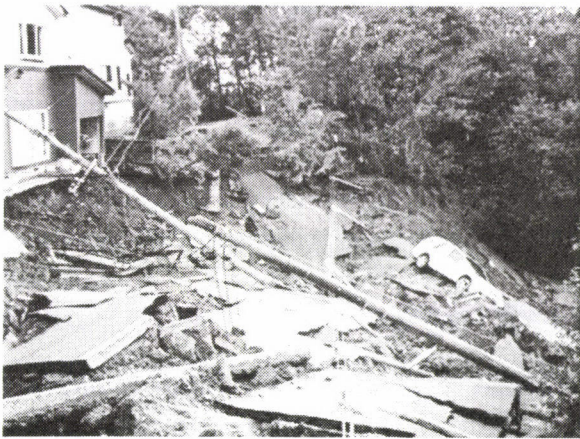
写真-12 高町4丁目の被災箇所その2(重力式擁壁の崩壊)
