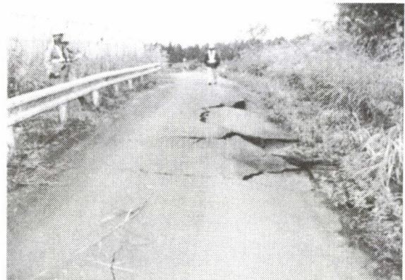
写真-4 擁壁 A 天端のひび割れ・陥没 (日本道路公団資料)
