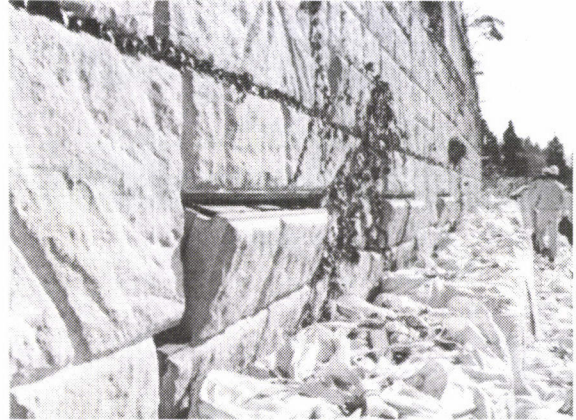
写真-2 擁壁 A の被害状況 (中段部のはらみ出し)
