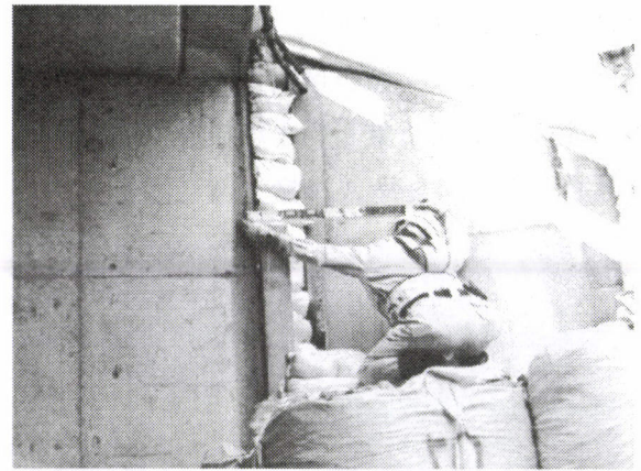
写真-8 擁壁 C の被害状況 (目地開き、背面土の流出)
