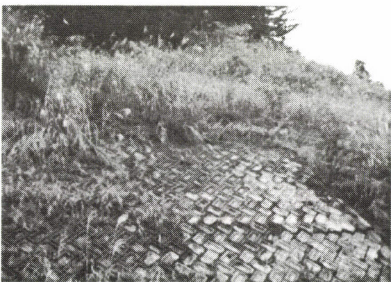
写真-5 擁壁 A 上部斜面のパネル積み擁壁のひび割れ (日本道路公団資料)
