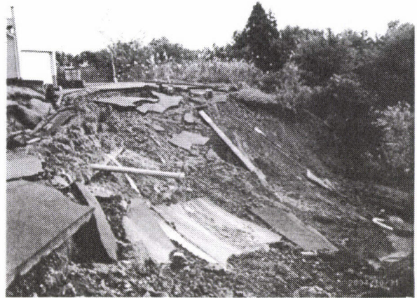
写真-11 高町4丁目の被災箇所その1(重力式擁壁の崩壊)
