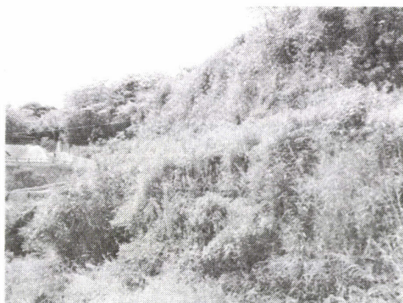
写真-4 地震後ののり面状況
