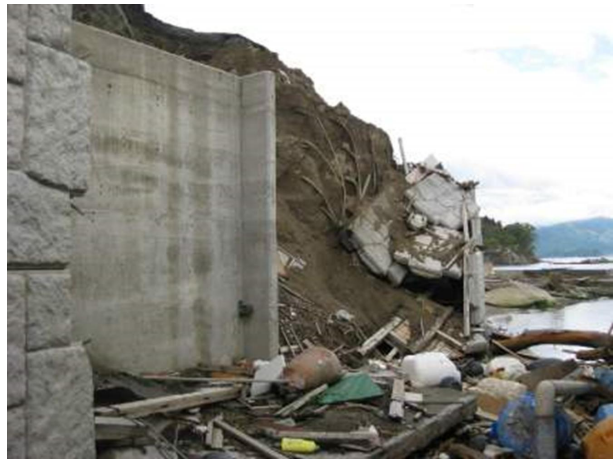
図-4 RSW1 補強土壁壁体切れ目と裏込め流失
