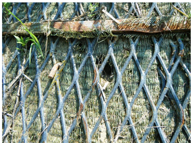
図-5 RSW3 補強土壁植生シートの軽微な損傷
