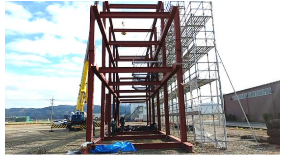
写真-6 実験設備（側面）
