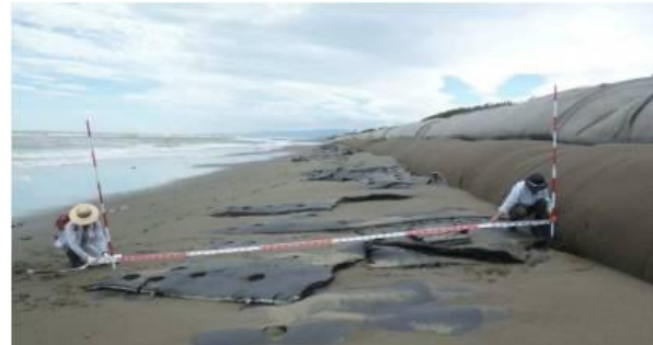
写真-8 洗掘防止マットの破断と流失 5)
