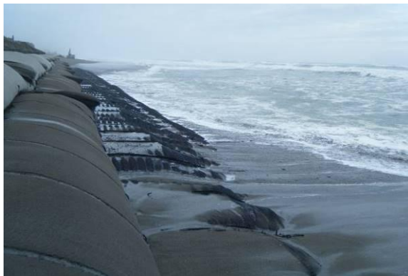
写真-14 台風 19 号接近時の覆土流失状況
