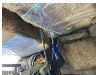
写真-4. 空隙箇所
