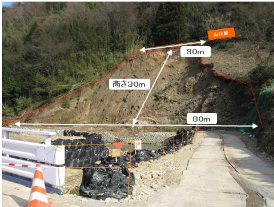
図-14 盛土崩壊状況
